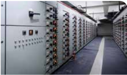
对关键设备进行连续监控
